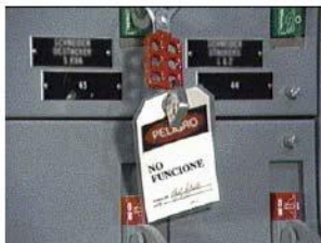
Bloqueo y etiquetado de Interruptor
