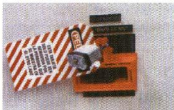
Bloqueo y etiquetado de termo magnético
