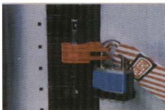
Bloqueo y etiquetado de Interruptor
