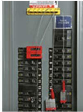
Bloqueo de interruptores
