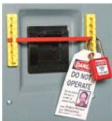
Bloqueo y etiquetado de interruptor
