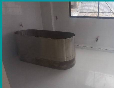
TINA HIDROMASAGE INSTALADA
